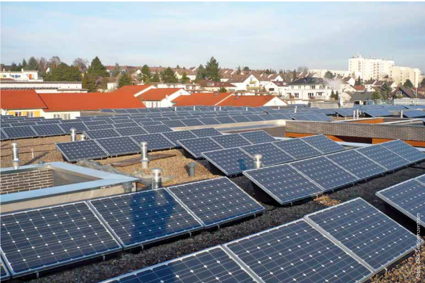
Zu der hier sichtbaren Photovoltaikanlage auf dem Dach des Seniorenzentrums gehört auch ein integriertes Back-Up-System (im Gebäude), das vor Stromausfällen schützt.
