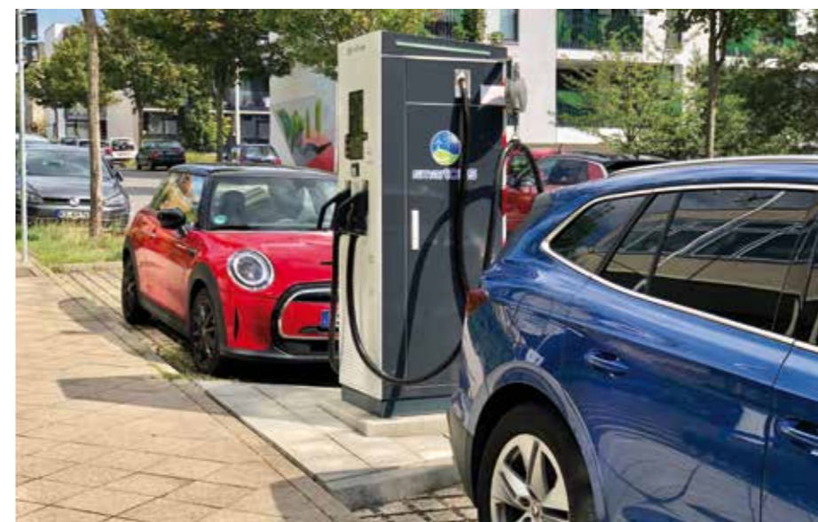
Neue Ladesäule mit zwei Ladepunkten (jeweils 50KW) in der Breitscheidstraße Nr. 6.
